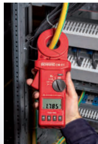
Meting van de bedrijfsaarding van een industriële distributie
